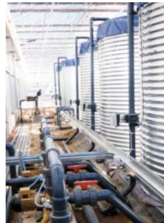
CENTRALE DI FERTIRRIGAZIONE
